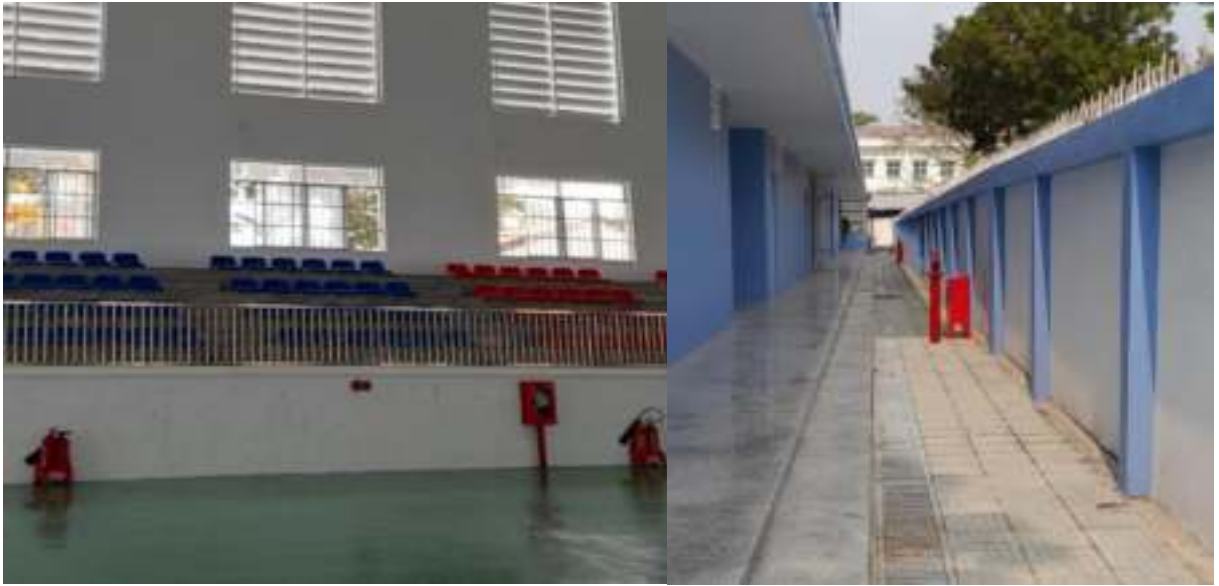
Hình 13: Hệ thống phòng cháy chữa cháy bên trong và bên ngoài Nhà thi đấu đa năng huyện Châu Thành
