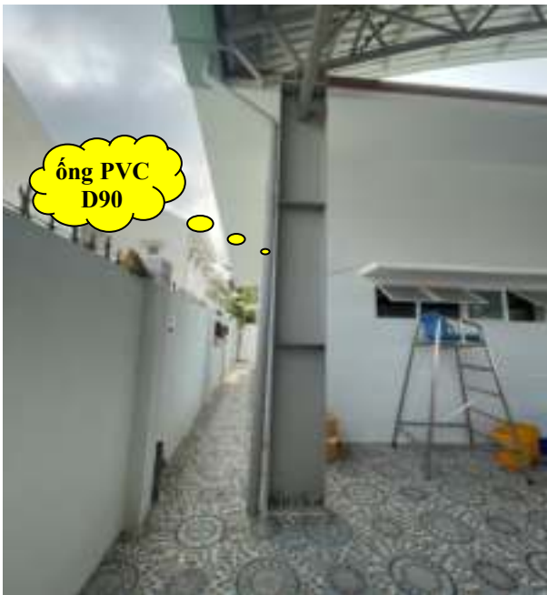
Hình 8. Ống thu nước mưa phần mái
