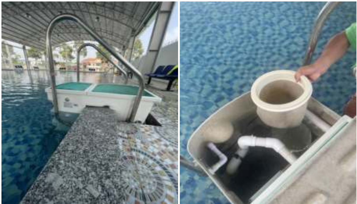
Hình 13. Máy lọc nước hồ bơi
