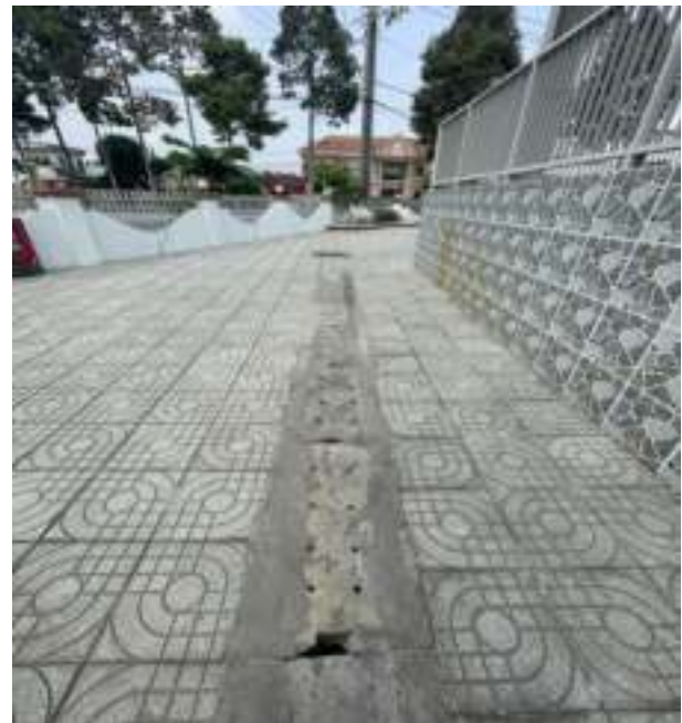
Hình 9. Cống thoát nước sân đường khu B
