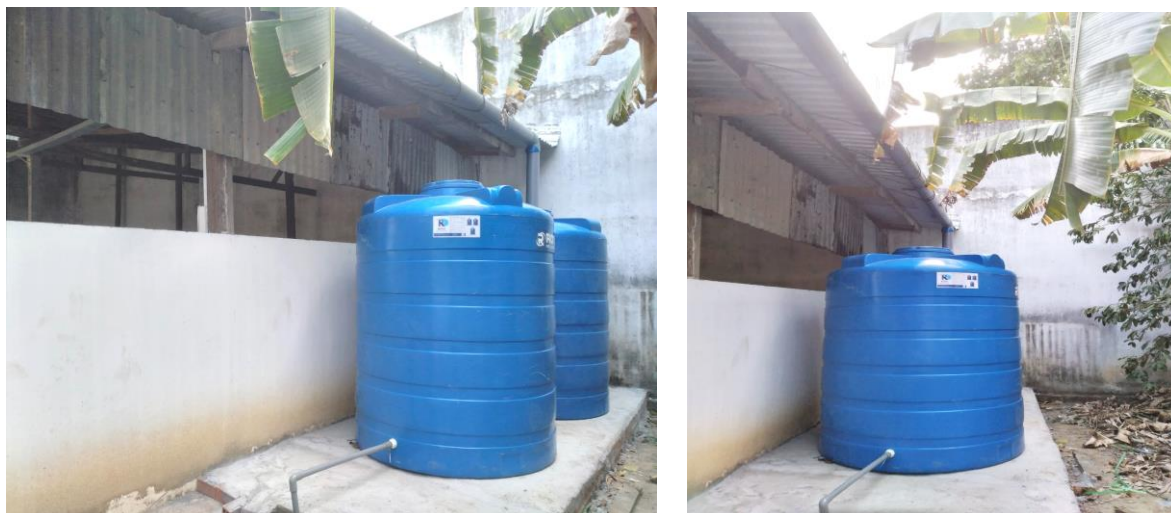
Hình 4. Bồn nhựa thu gom nước mưa
