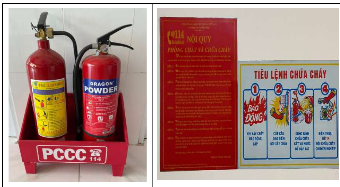
Hình 7. Hình ảnh bố trí thiết bị chữa cháy tại cơ sở
