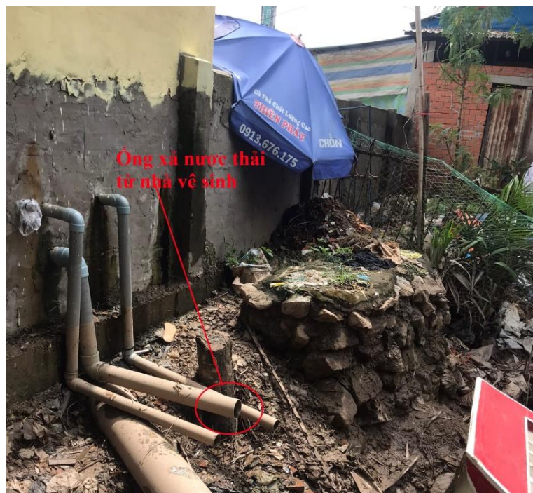
Hình 6. Ống xả nước thải sinh hoạt ra rạch Chợ
