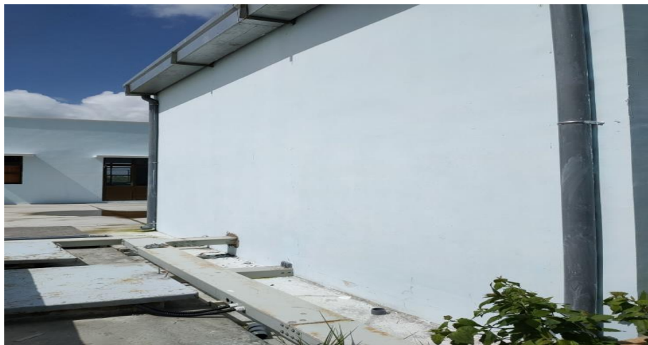
Hình 10: Tuyến ống thoát nước mưa từ mái nhà
