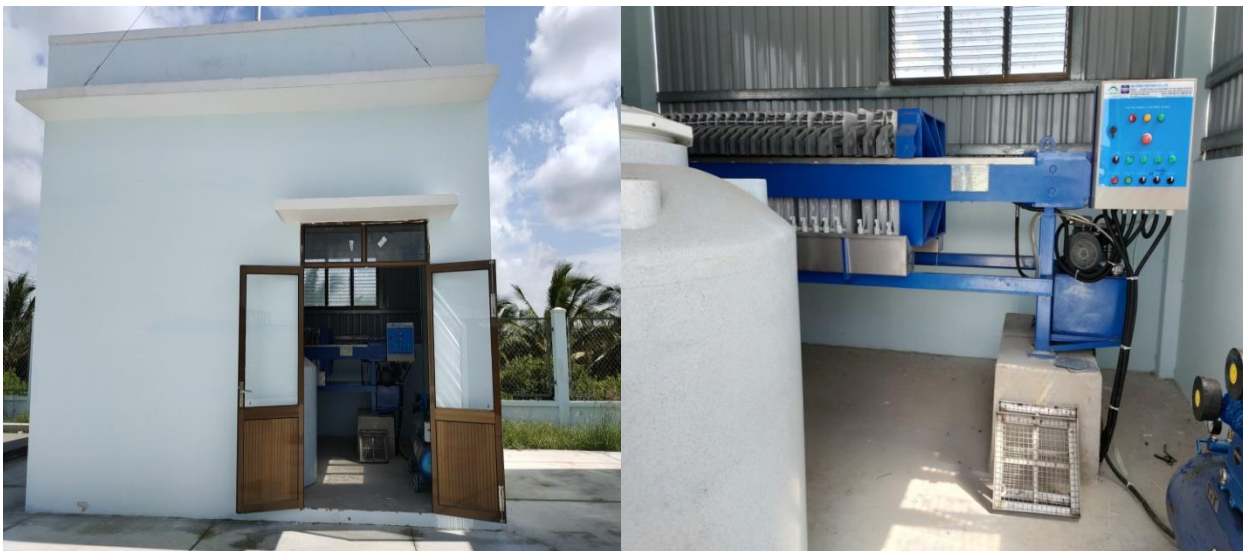
Hình 19: Nhà nén bùn và máy ép bùn băng tải
