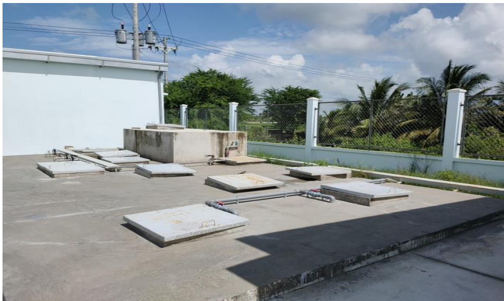
Hình 16: Hệ thống xử lý nước thải của dự án
