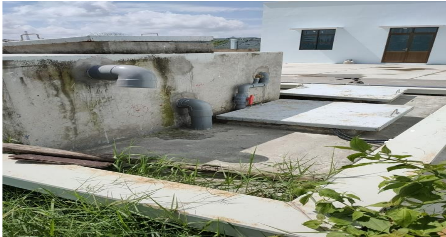
Hình 11: Tuyến ống dẫn nước thải tại HTXLNT
